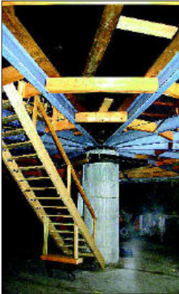
Eine Betonsäule stützt mittig im Güllepottdas Drehkreuz des Unterbaus der Solar-Anlage, die Treppe führt zum Technikraum.
